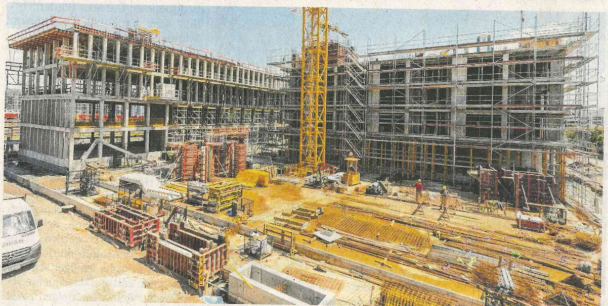
Soll bis Ende kommenden Jahres schlüsselfertig übergeben werden: das LIV-Bürogebäude im Glückstein-Quartier.
